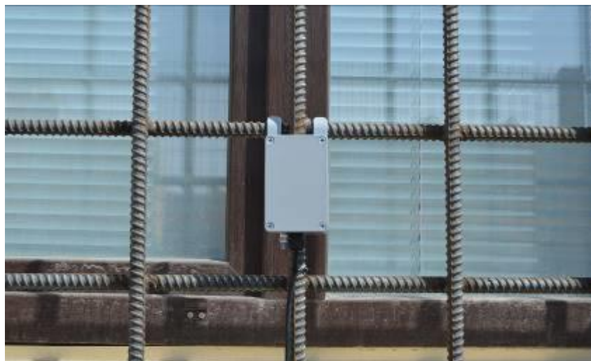
Рисунок 18 – Блокирование оконной решетки
