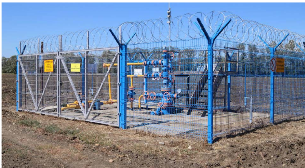
Рисунок 1 - Пример площадки с сетчатым ограждением
