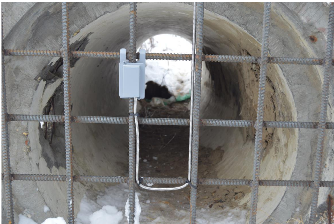
Рисунок 1- Установка ДВ-ИО-Г на решетке водопропуска
